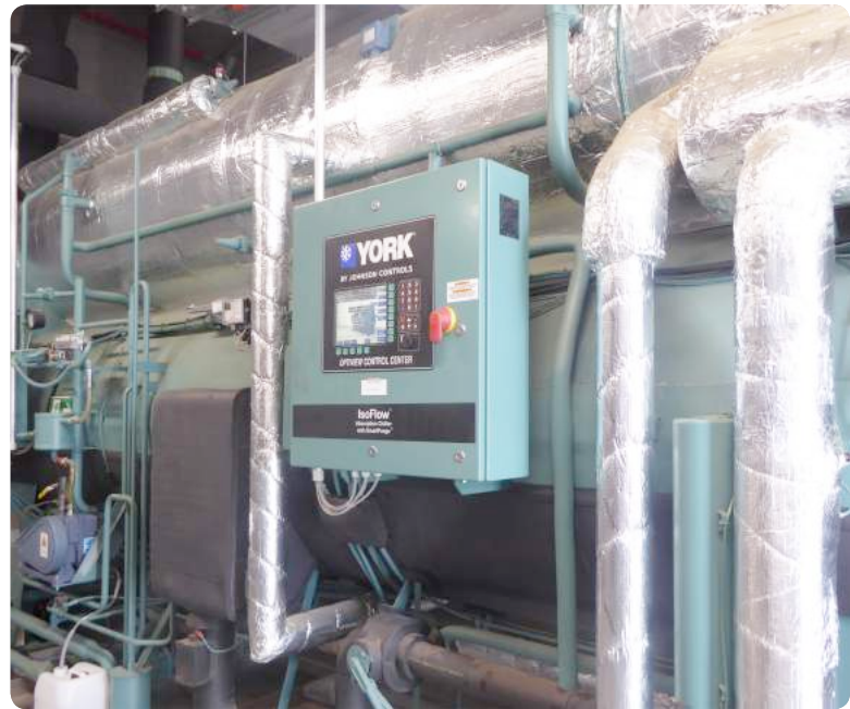
Kältemaschine und Blockheizkraftwerk müssen hinsichtlich ihrer Leistungscharakteristik gut aufeinander abgestimmt werden. (Bild: Almo)
