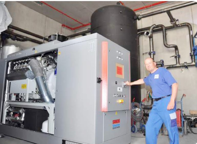
Das kompakte Blockheizkraftwerk ist eine der zentralen Komponenten der Energietechnik bei Almo. (Bild: Almo)
